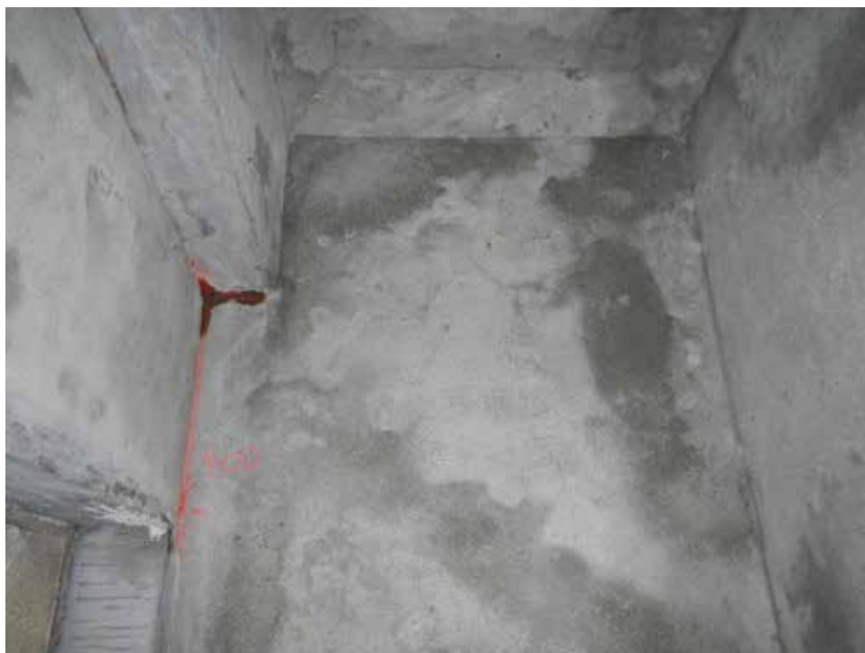
建物内部の漏水箇所です。降雨に関係なく漏水しているので、躯体内部に外部から浸入した水が溜まる空隙（ポーラス化した箇所）があると考えられます。
