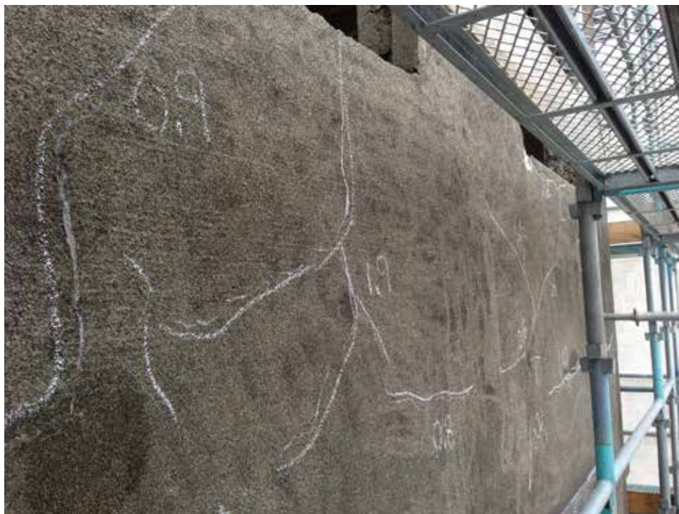
写真のチョークでマーキングした箇所が外壁のひび割れです。白華、漏水が確認できます。躯体まで、漏水が達していると推測される箇所多数ありました。
