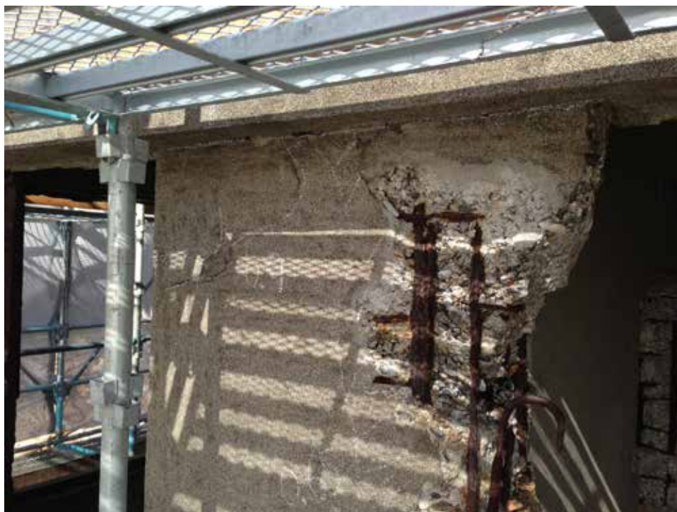
外壁コンクリートの剥離、欠損箇所です。露出した鉄筋は、何十年と風雨にさらされて、発錆、腐蝕しています。
