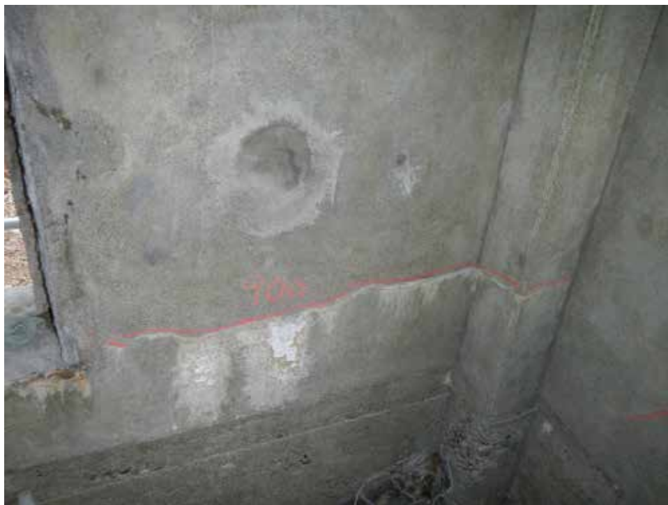
建物内部のひび割れです。長年の漏水で白華（エフロ）が析出しています。
