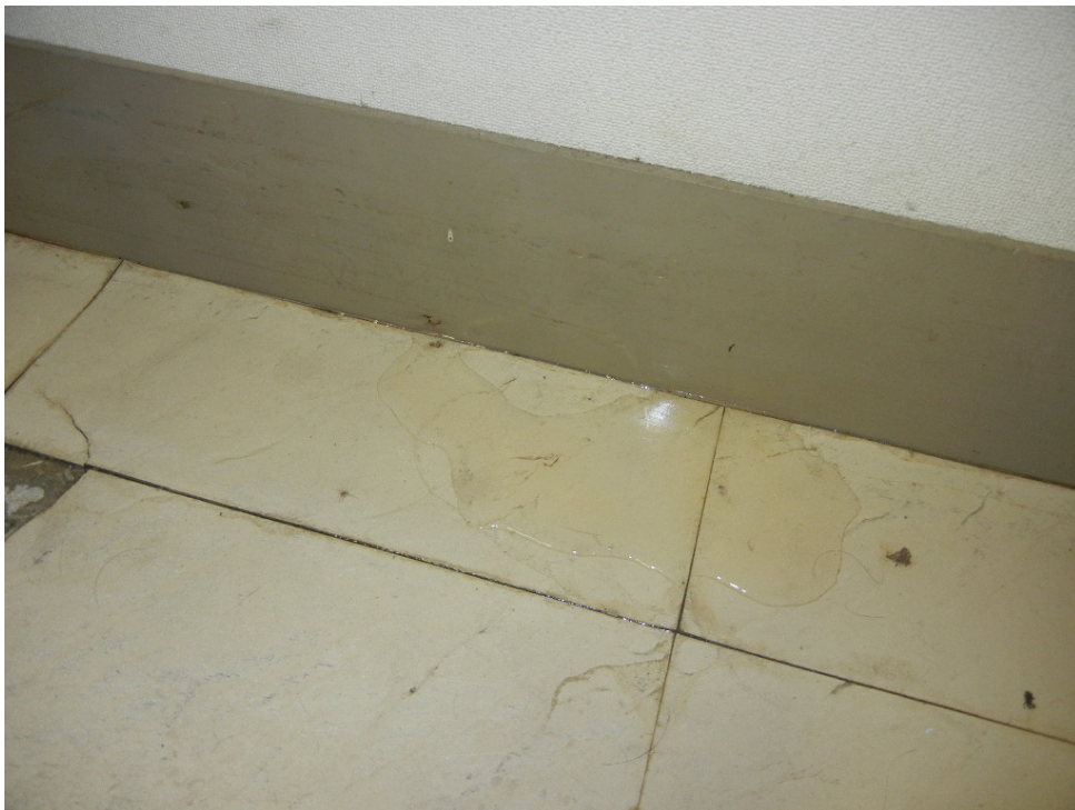
室内床～壁入隅で漏水を確認
