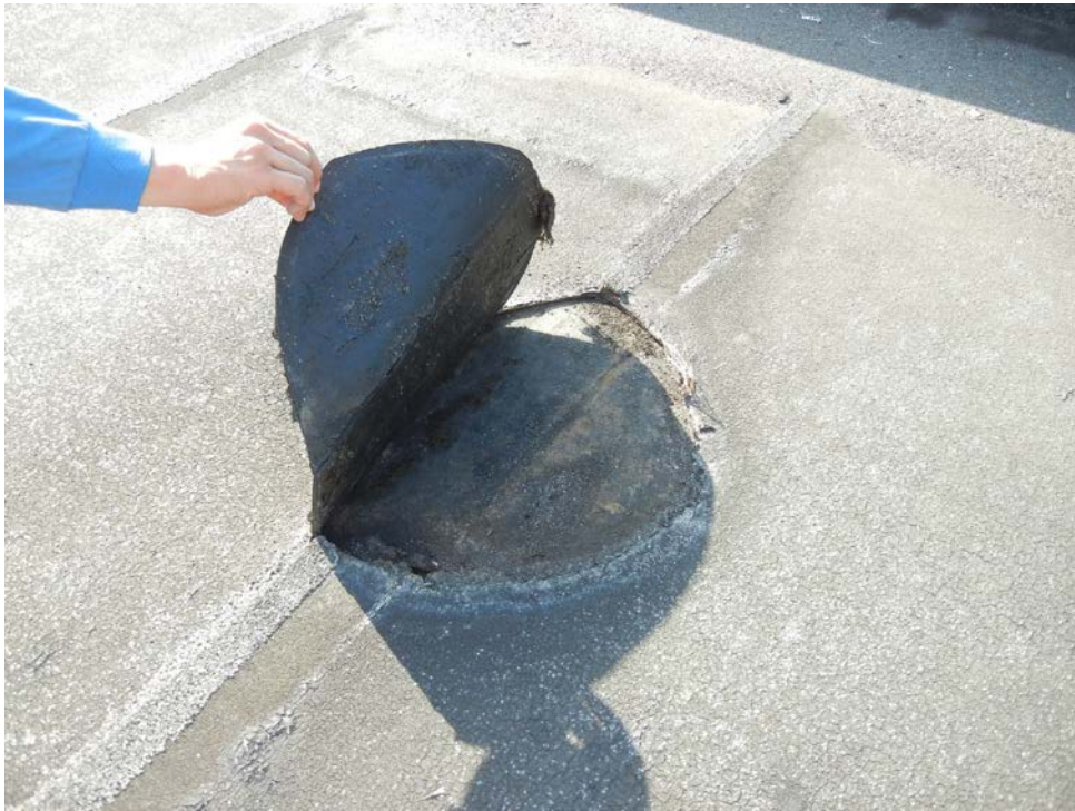
シート補修箇所の剥離
