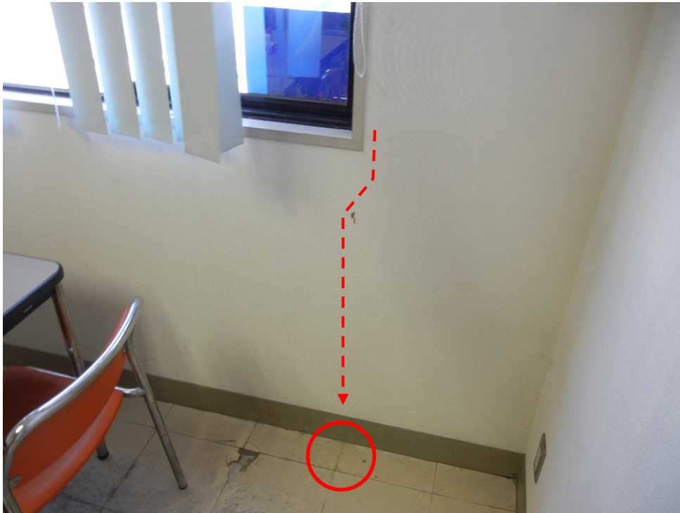
室内床～壁入隅で漏水を確認
