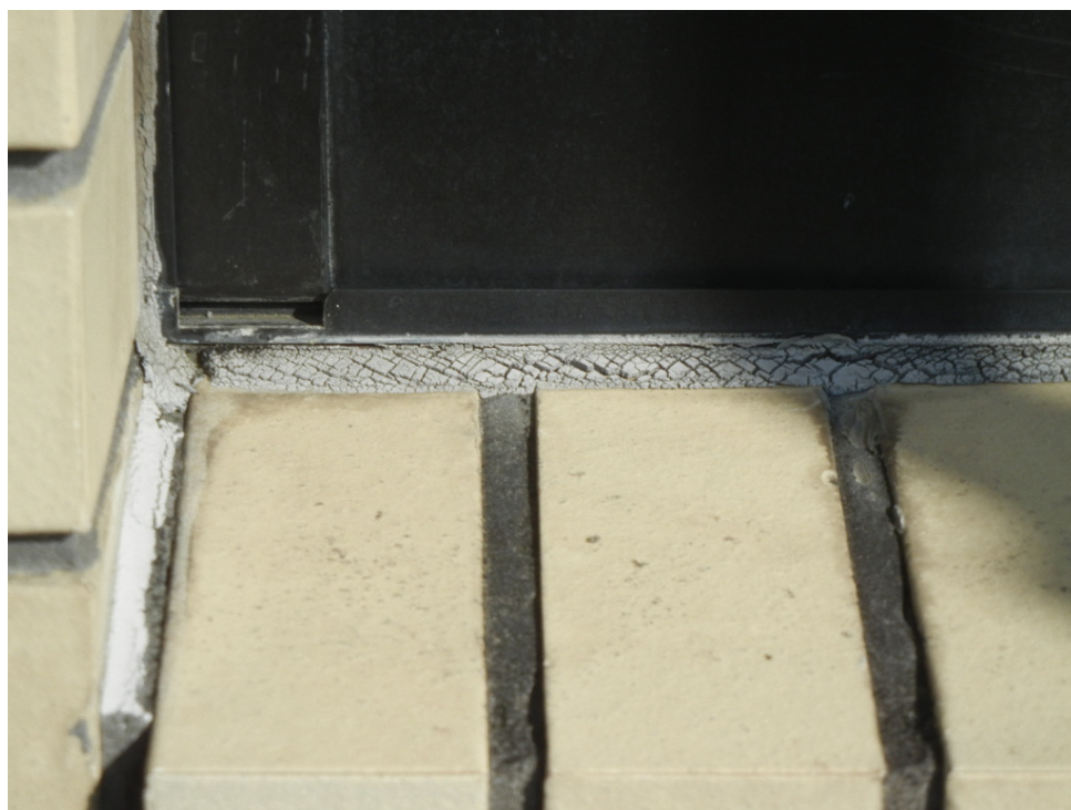
タイル目地、取合いシールの劣化
